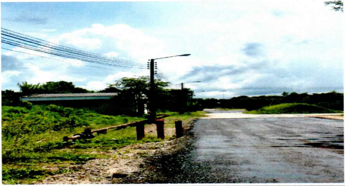
รูปที่ ๓ เสาไฟฟ้าคอนกรีต ขนาด ๘.๕ เมตร คลังอาวุธปล่อยนำวิถีพื้นสู่พื้น ๒ กอว.สพ.ทร. ฟิวส์ไลน์ (HT Drop Out Fuse)
