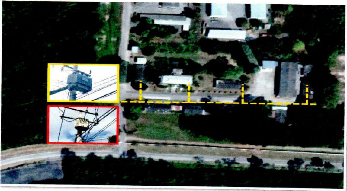
รูปที่ ๔๒ ตำแหน่งที่ติดตั้งหม้อแปลงไฟฟ้าขนาด ๕๐, ๑๐๐ KVA จุดรักษาการณ์แผนกคลังออมภัณฑ์ กคส.สพ.ทร.
