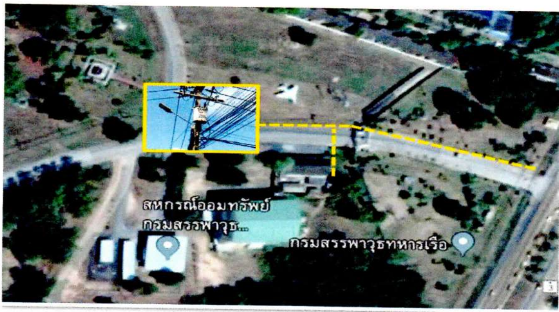
รูปที่ ๑๘ ตำแหน่งที่ติดตั้งหม้อแปลงไฟฟ้าขนาด ๕๐ KVA. สามแยกสหกรณ์ออมทรัพย์
