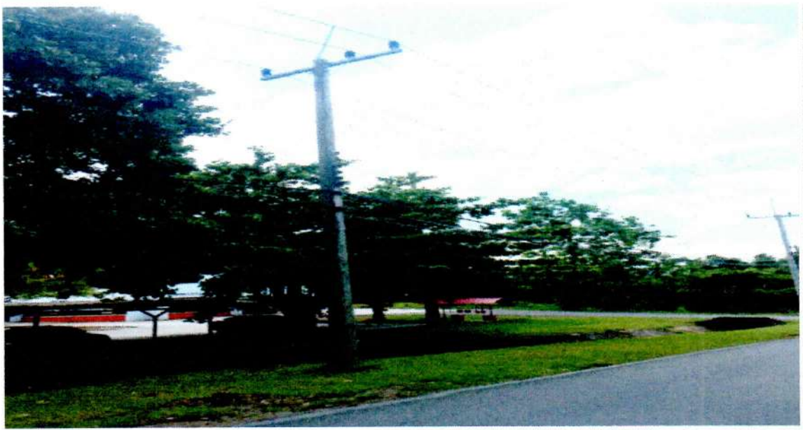
รูปที่ ๒ เสาไฟฟ้าคอนกรีต ๑๒ เมตร ข้างอาคาร กอง สน.สป.ทร.
