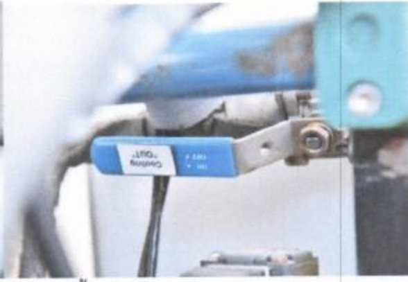
Valve น้ำหล่อเย็นออก
