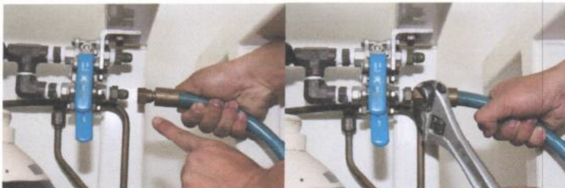
ต่อสายอากาศหลักเข้ากับถังอากาศความดันสูง
