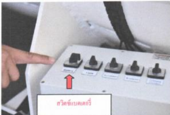
18. เปิดสวิตซ์แผงควบคุมที่กล่องควบคุมด้านบน
